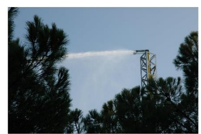
Infrastructures de prévention du risque incendie
