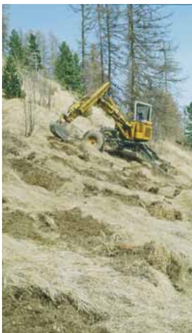
30 - La pelle araignée, en opérant ponctuellement aux endroits appropriés, permet de faire des potets travaillés en conditions difficiles. Elle accède à des pentes jusqu'à 60%.
